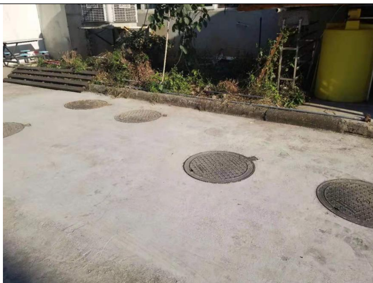
图 4-2 污水处理站现场图
