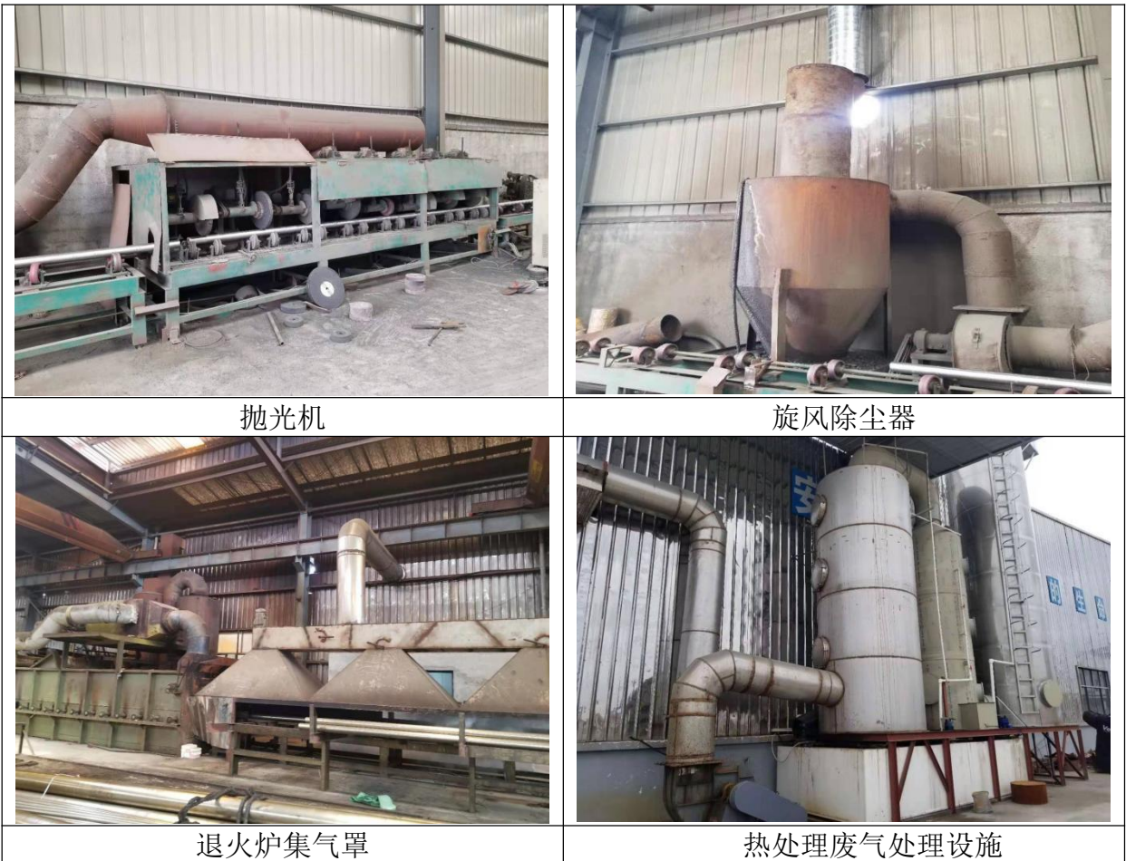
图 3-4 抛光粉尘处理设施+热处理废气处理设施现场图
