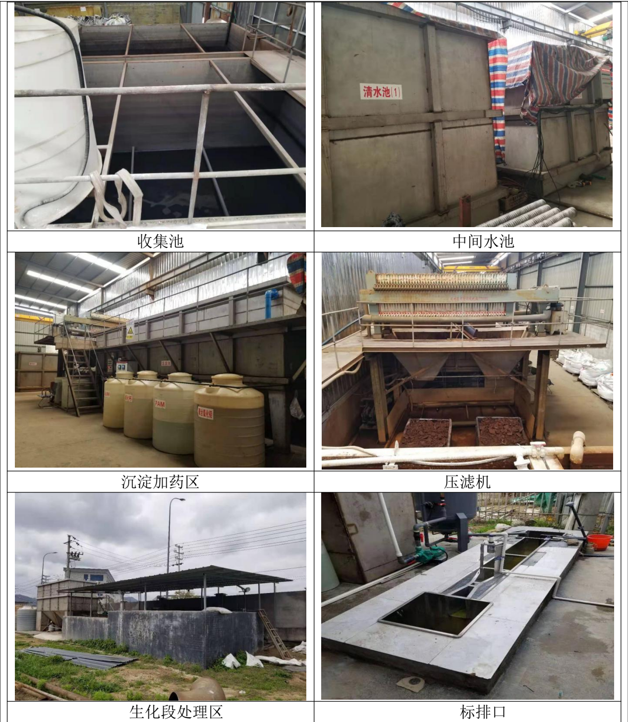
图 3-2 污水处理设施现场图
