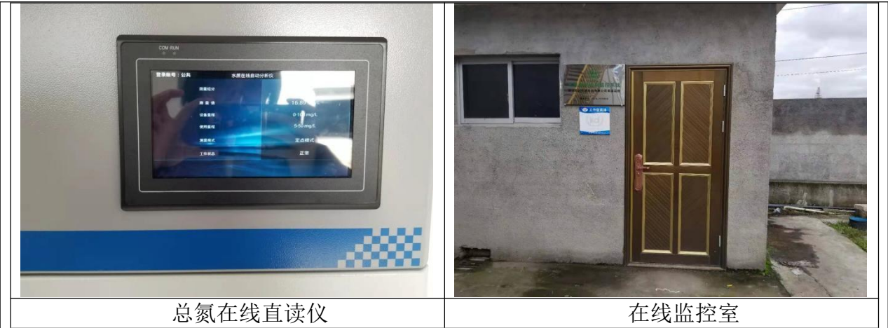
图 3-3 污水在线监控现场图
