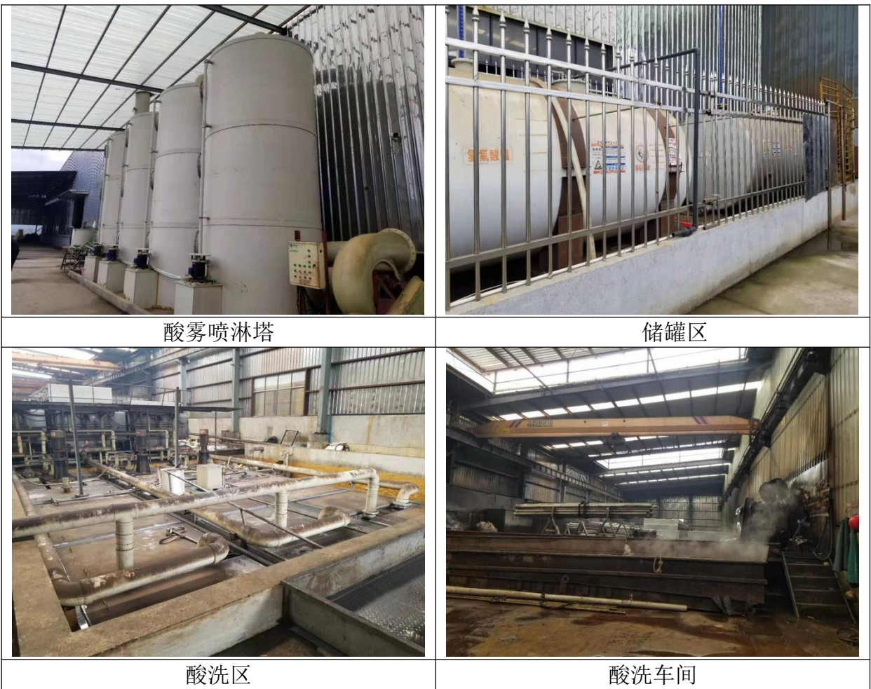
图 3-3 酸洗区域及废气处理设施现场图
