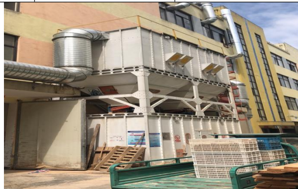
白坯粉尘除尘设施
