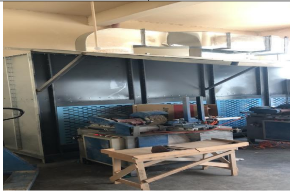
漆后打磨除尘设施
