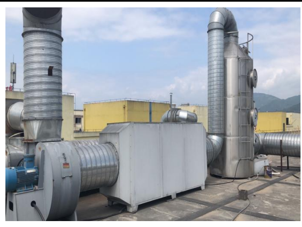
喷漆废气处理设施
