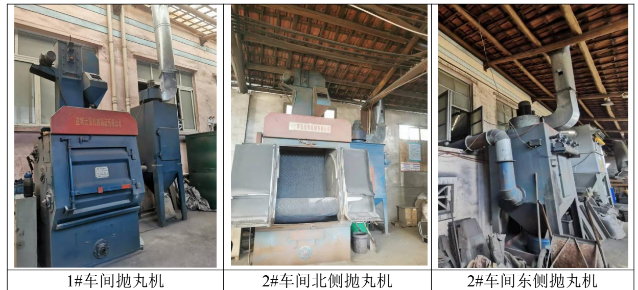
图 3-4 抛丸机废气产污点及处理设施现场图
