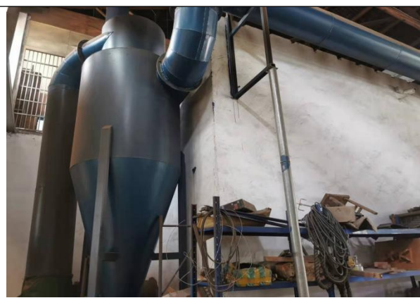
1#车间中频炉烟尘处理设施
