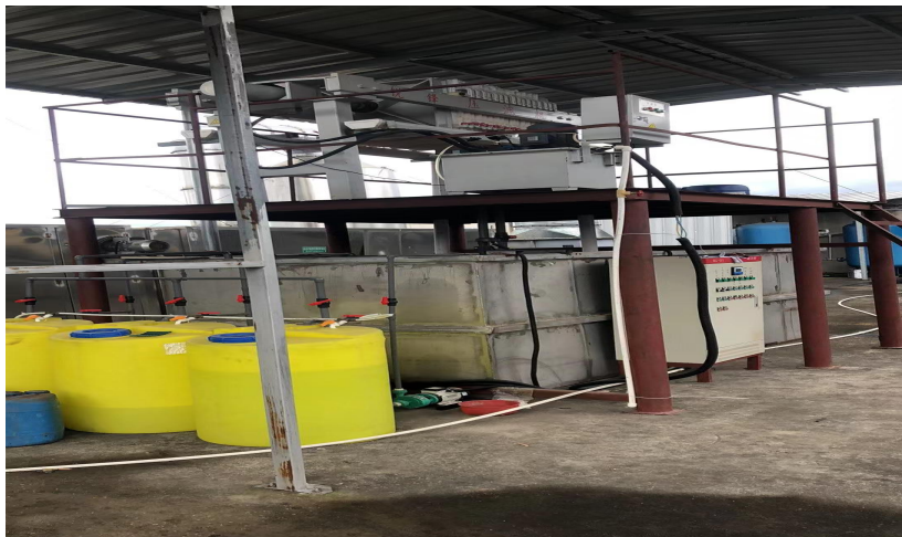
图 5-2 项目废水处理设施现场图
