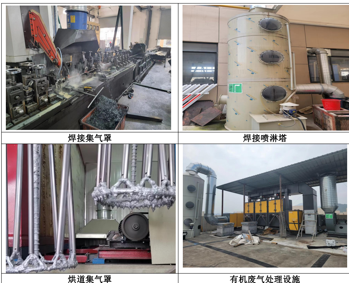
图 5.3 热处理线产污节点和处理设施现场图
