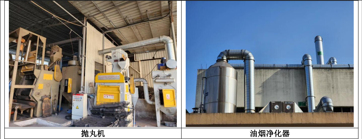
图 3-2 废气处理设施现场图
