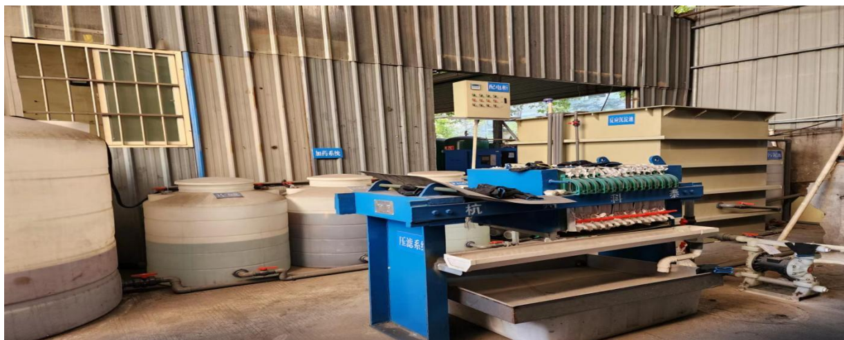
图 3-1 污水处理设施
