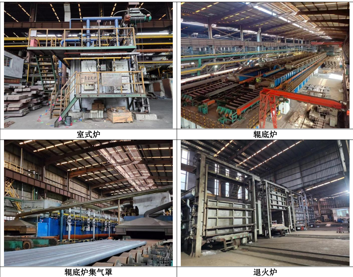
图 3-2 废气处理设施现场图
